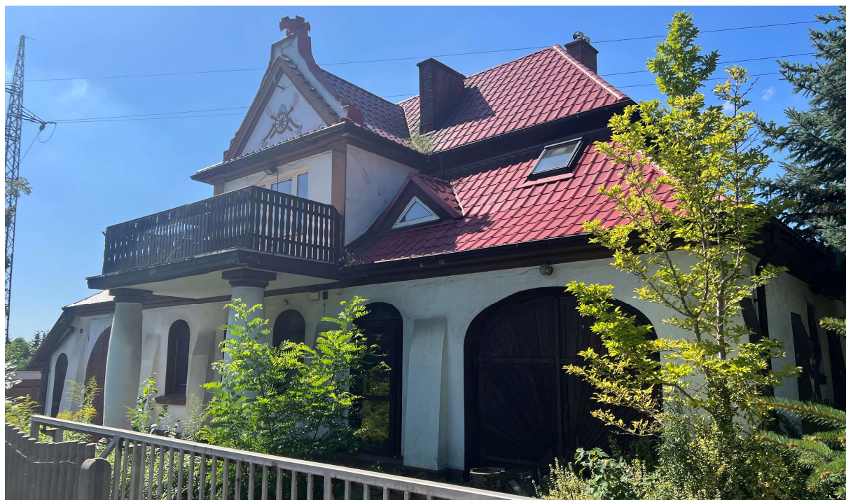
Rysunek 10. Budynek dawnej siedziby Straży Pożarnej wymagający remontu.
