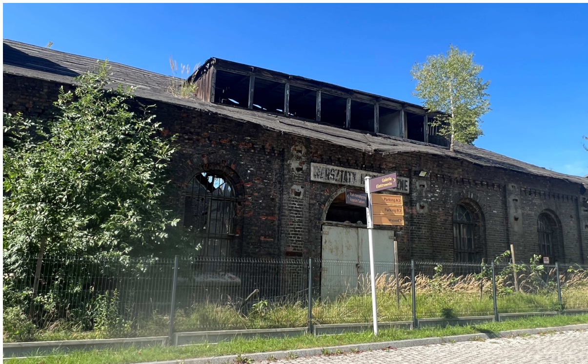
Rysunek 9. Zdegradowana zabudowa byłej KWK Saturn – warsztaty mechaniczne.
