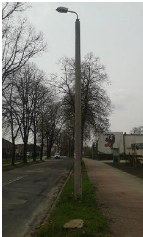
Przykład oświetlenia na linii kablowej na słupach betonowych WZ
